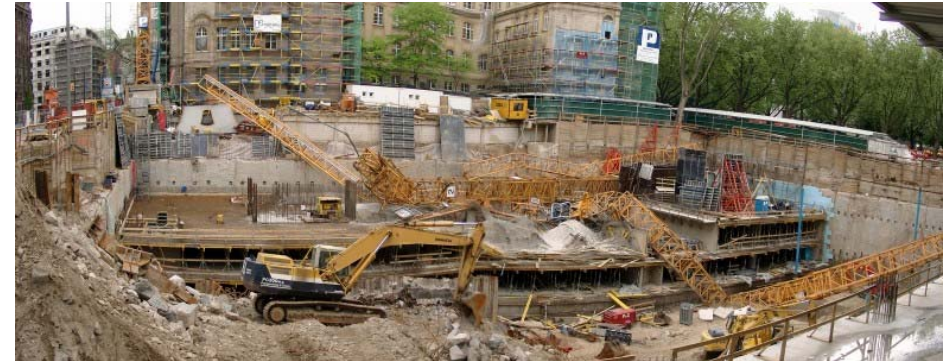
Kraneinsturz auf der Königsallee in Düsseldorf am 29.04.2003
