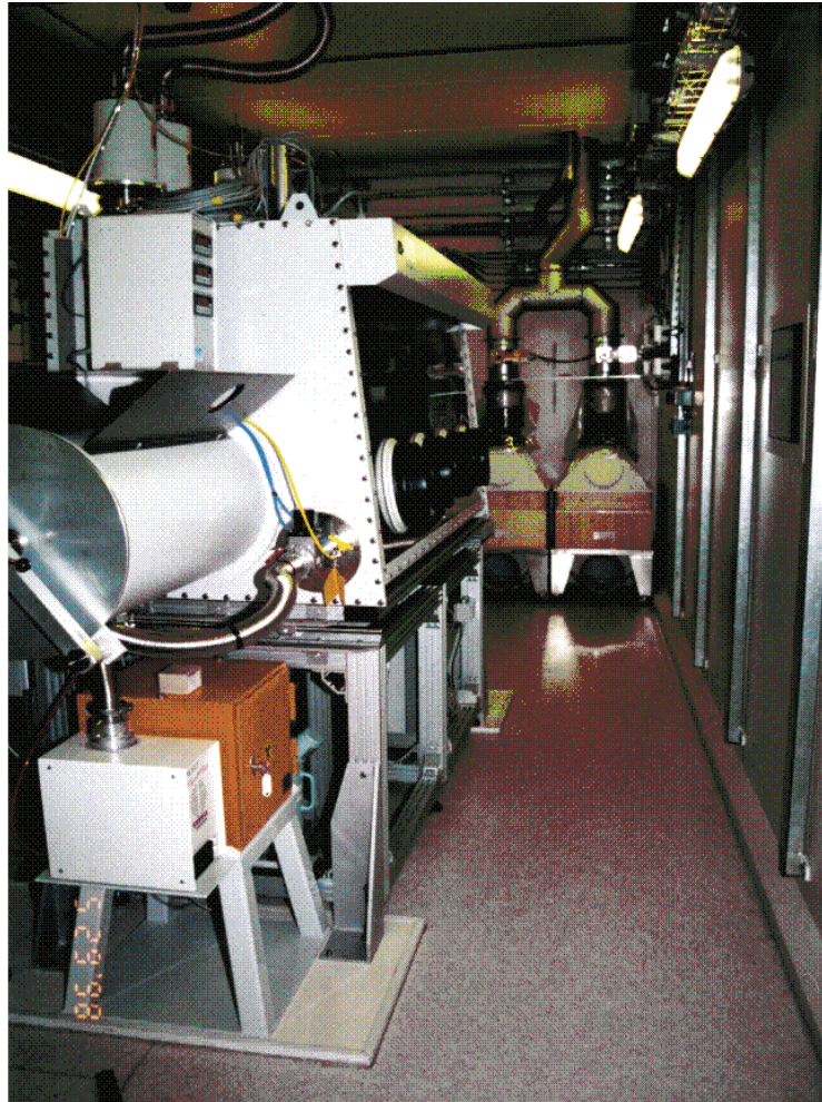
Abbildung 2: Operatorseite der Handschuhbox mit Filtern, Schleuse und Teilen der Lüftungsanlage
