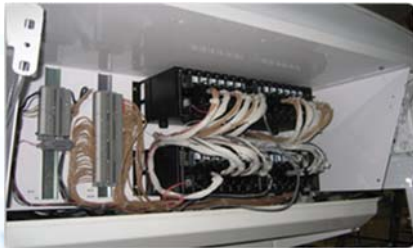
Installation direkt in der beweglichen Kabine
